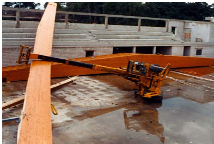
Der orange Bagger sollte einen Brettbinder für die neue Halle anheben, war dafür aber zu schwach, kippte um und zerstörte das Material. Ein größerer Kran brachte dann einen neuen Brettbinder an die vorgesehene Position.
